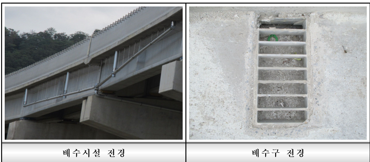
【표 2.1-2】 배수시설 손상물량
